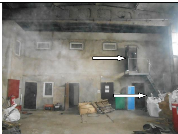
Котельная, бытовые помещения
